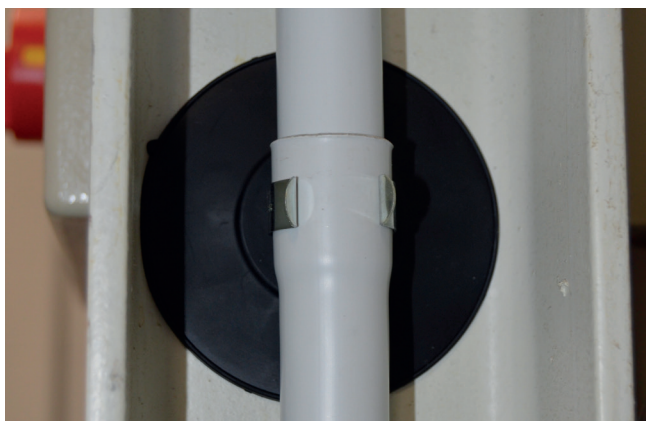
Fixation de tuyaux directement sur des poutres en acier
